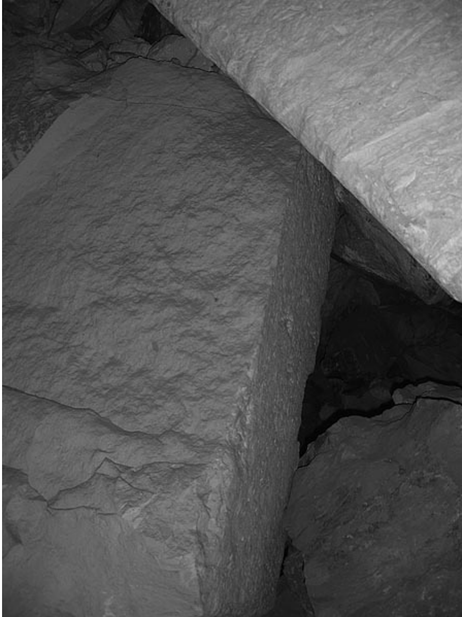
Рис. 58. Рухнувшие блоки перекрытия центральной камеры пирамиды Сахура
