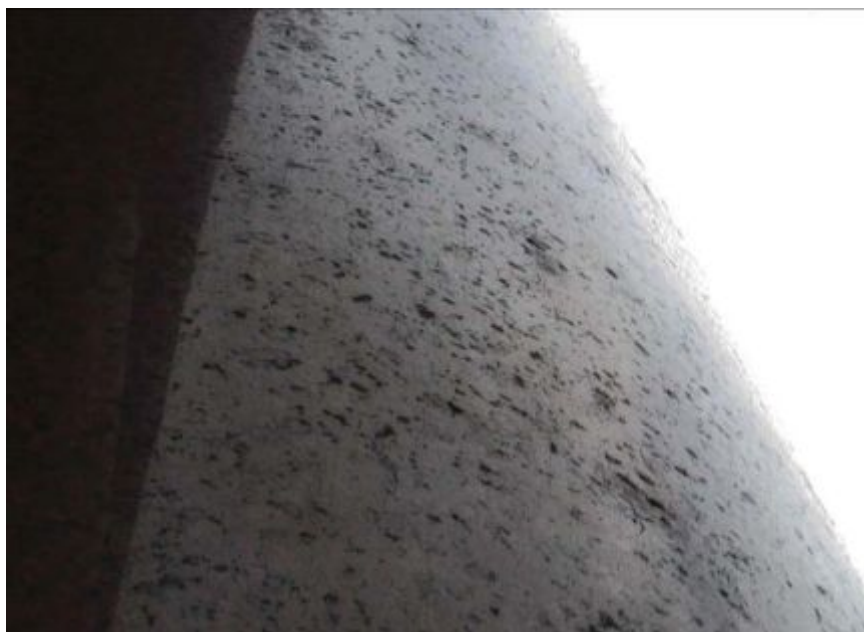
Рис. 48. Каверны на колоннах Исаакиевского собора
