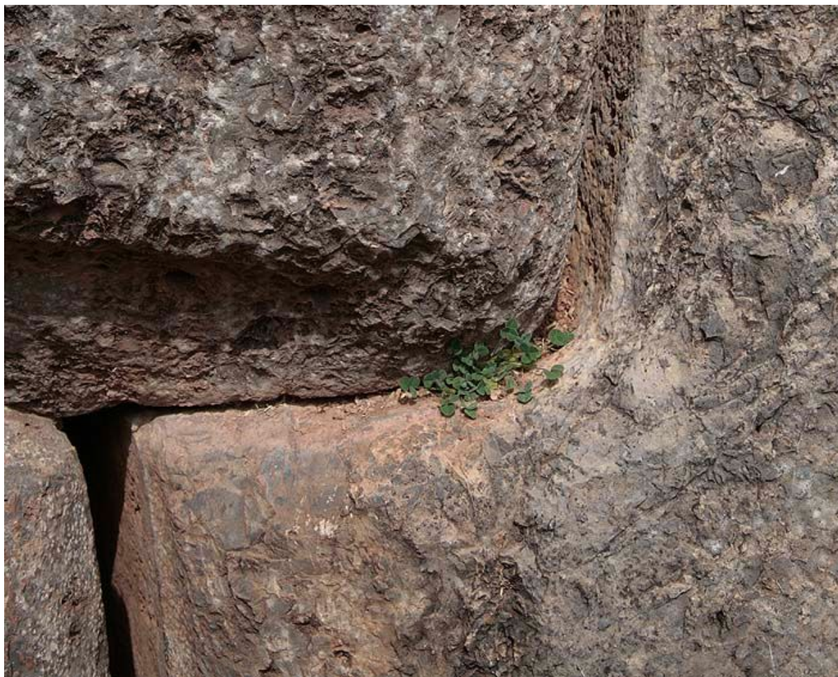
Рис. 103. Поверхности сопряжения на разошедшихся блоках
