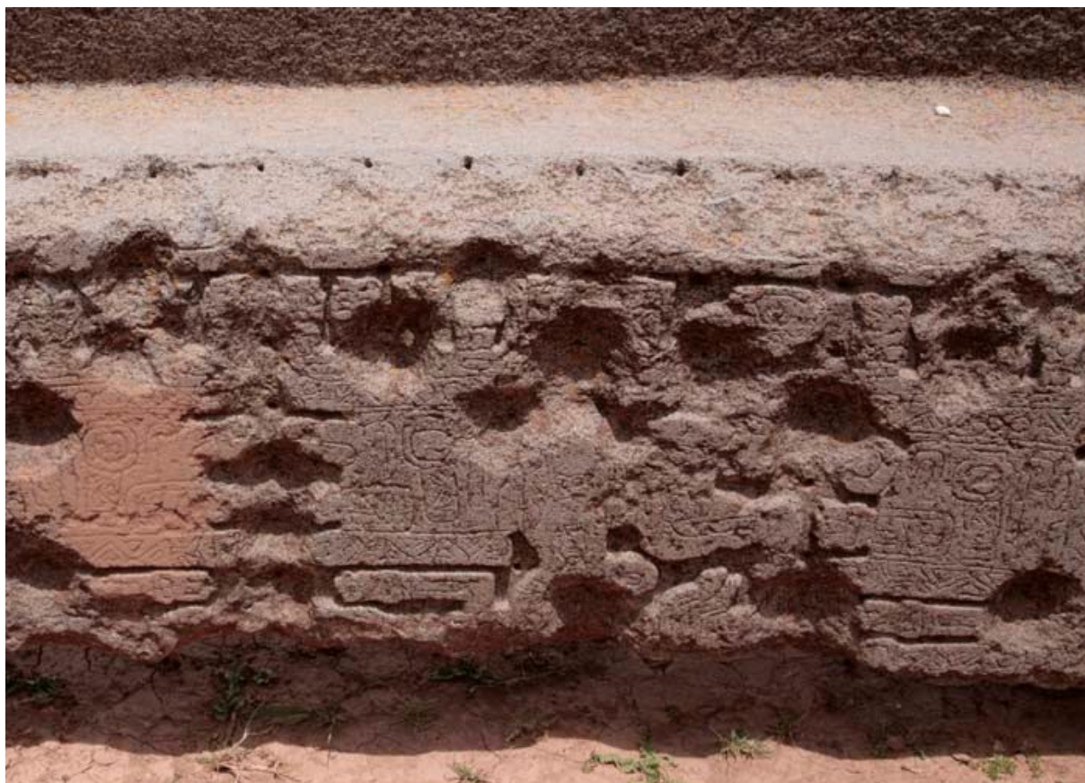
Рис. 214. Поврежденные символы на перекрытии ворот
